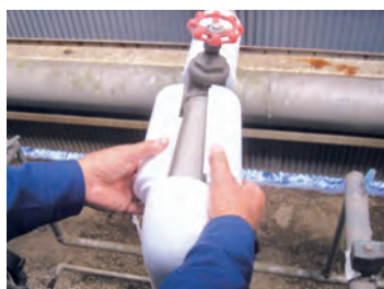
パイプカバー(配管断熱)
